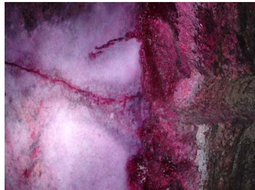
Kuva 2. Tunkeumaneste paljastaa raot.
